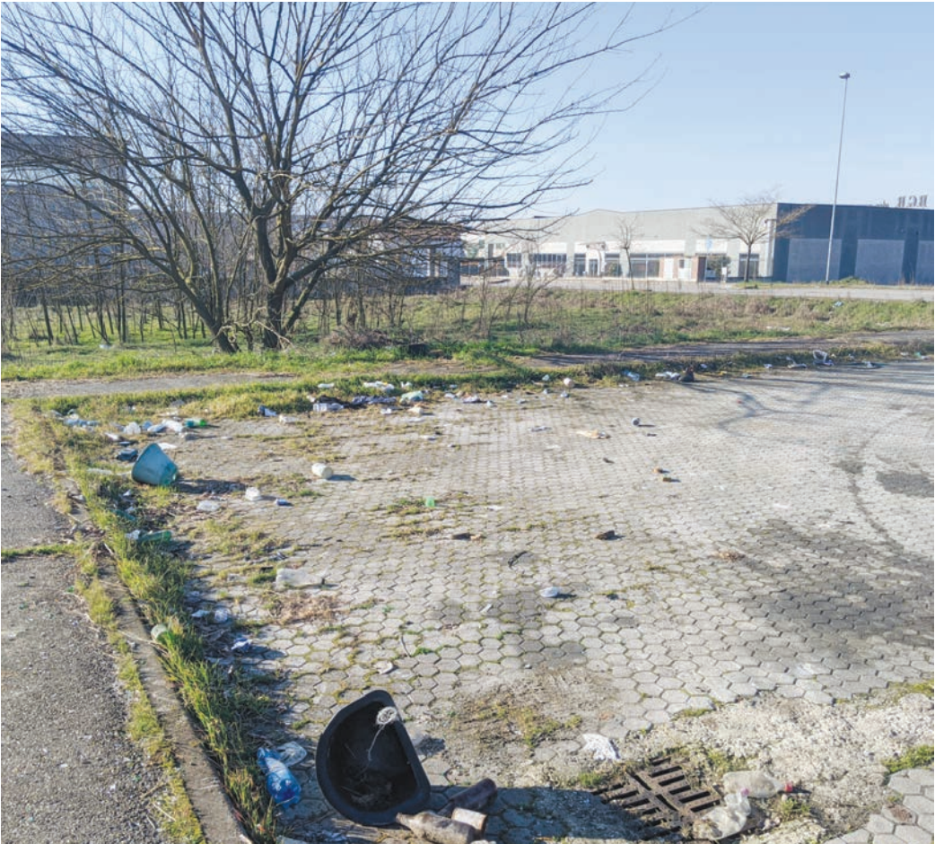
Il degrado del parcheggio tra via Chiri e via Saragat nel quartiere Bivio Vela - Riso Scotti
