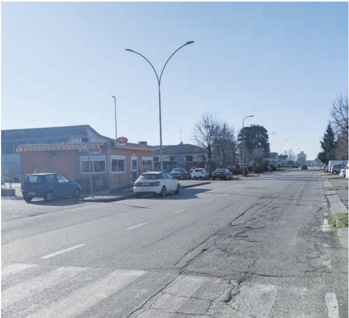
Via Ponzio: anche qui il manto stradale è da rifare
